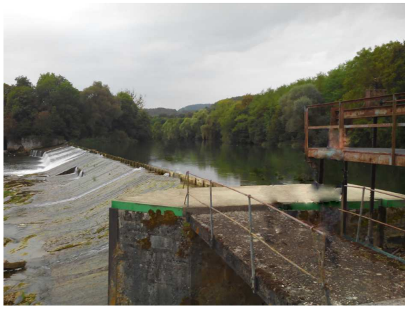
(a) Seuil de dérivation
